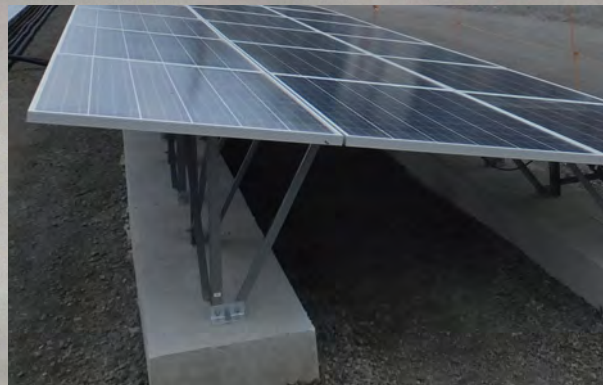
太陽光パネル
