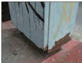
施工前腐食状況
