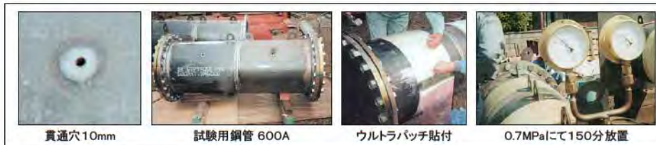
貫通穴10mm 試験用鋼管 600A ウルトラパッチ貼付 0.7MPaにて150分放置
