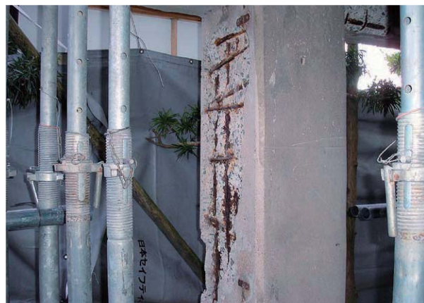
柱の劣化状況
