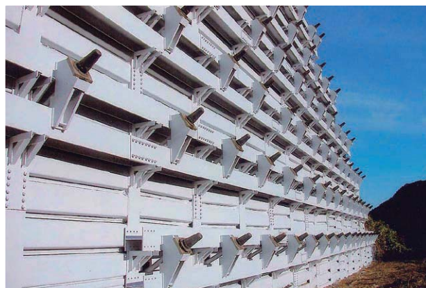
【のり面補強鋼材の防錆】
